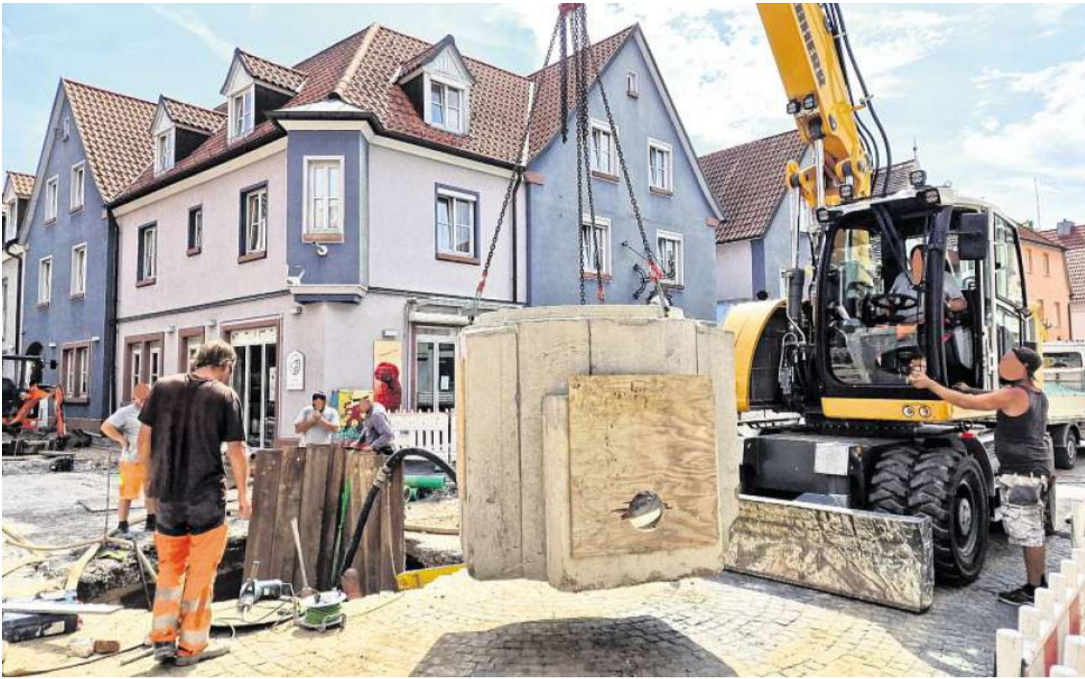
Im Zuge der Ortssperrung in Veitshöchheim wurde am Freitag ein Kanalstück an der Kreuzung Kirchstraße eingelassen.
