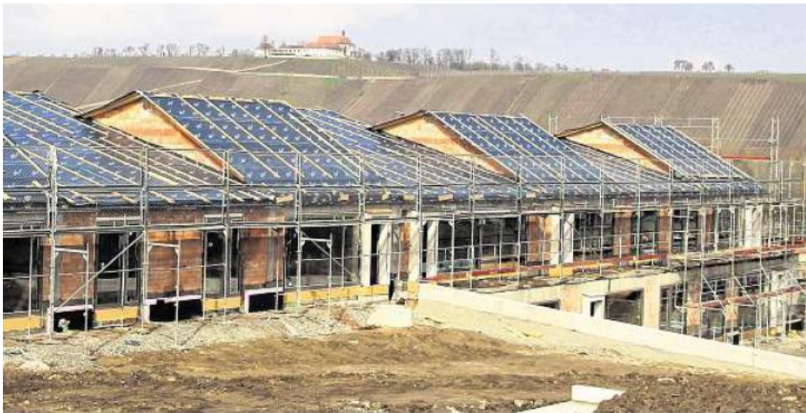
Der Bau des Nordheimer Kindergartens ist weit fortgeschritten und liegt voll im Zeitplan. In den Weihnachtsferien soll der Umzug vom Altbau in das neue Zuhause erfolgen. FOTO: PETER PFANNES
