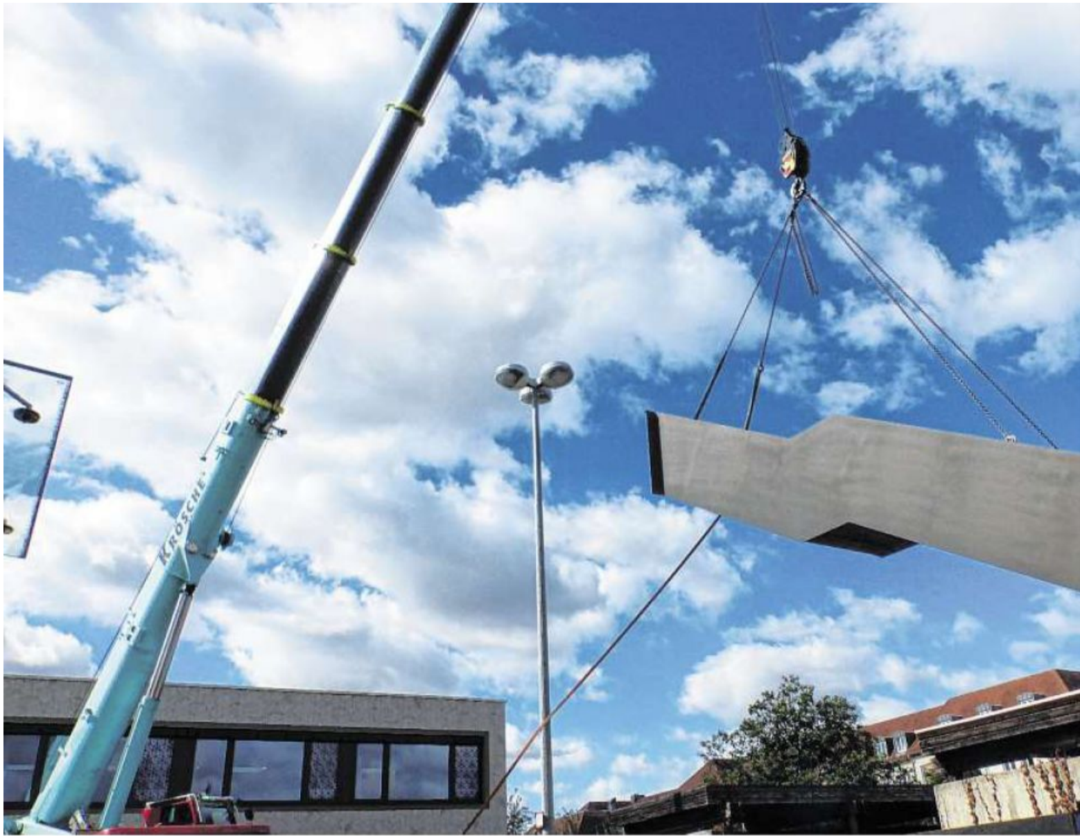
Fünf Tonnen schwerer Stahl, neun Meter lang. Wie ein riesiges Insekt hängt die Treppe in luftiger Höhe an den Kranseilen.
